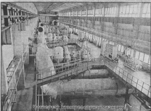
Четвертая компрессорная станция
