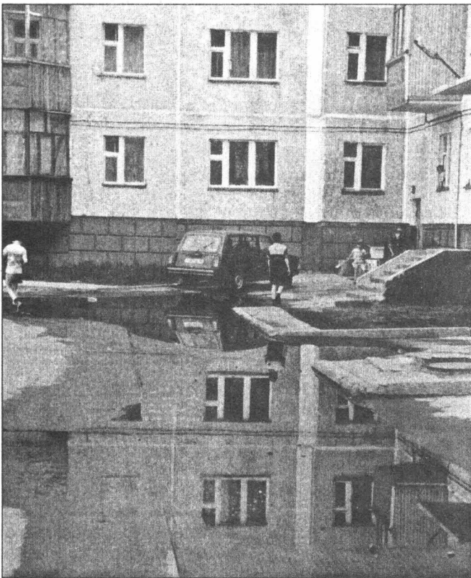
«Вечная» лужа — ошибка строителей дороги.
