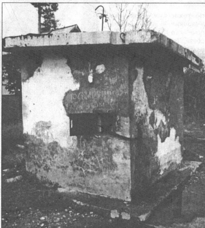
Водозаборные колонки уже закрыты.
